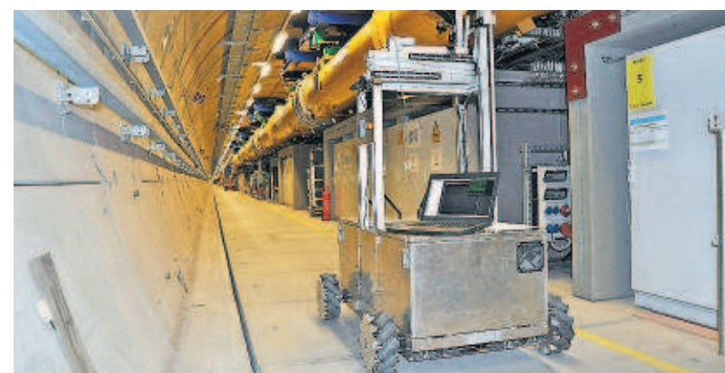
Der Wartungsroboter der Hochschule fährt durch den Tunnel des Röntgenlaser European XFEL. Die Buxtehuder bauen einen zweiten Roboter.
