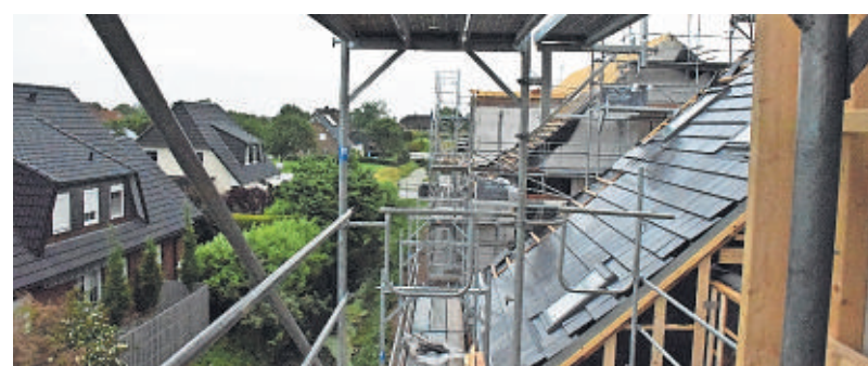
Zwei der drei Dächer, über denen nun die Richtkrone hängt. Foto Richter
