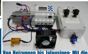
Von Heizungen bis Jalousinen: Mit diesem Testaufbau werden verschiedene Steuerungen demonstriert.
